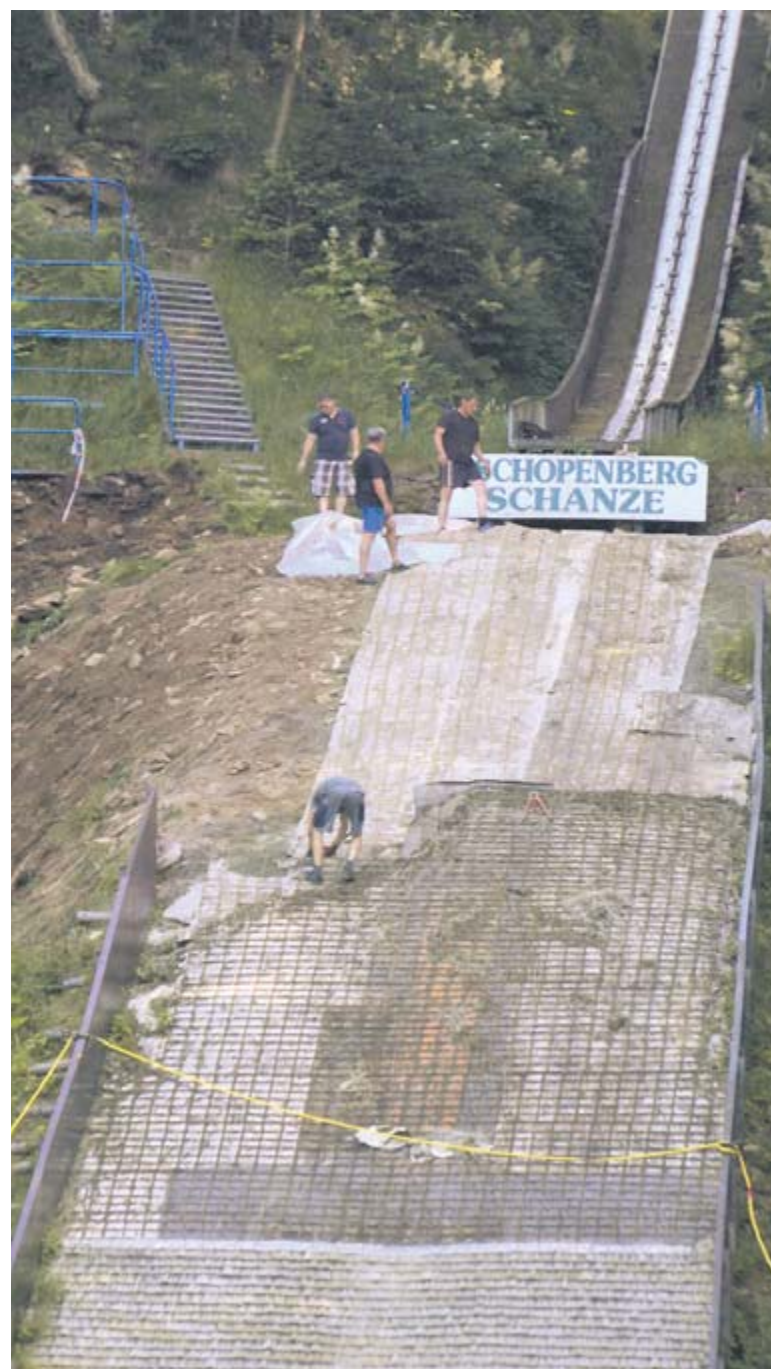
Bei der Demontage des alten Belags auf der Schanze am Zschopenberg kommen die verschiedenen Schichten zum Vorschein. FOTOS: ANDREAS BAUER
